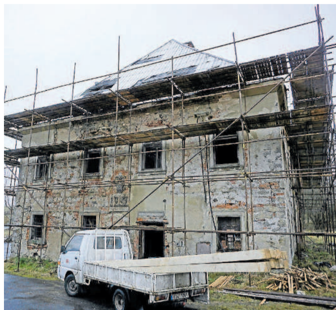
OBNOVA. Majitele čeká hodně práce, budova zámečku má mimo jiné propadlé stropy. Foto: Jan Kilián
